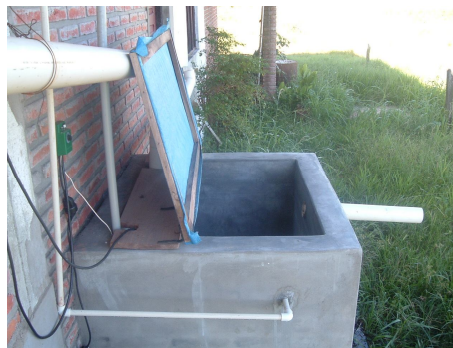
Figura 15. Tanque de sistema de
